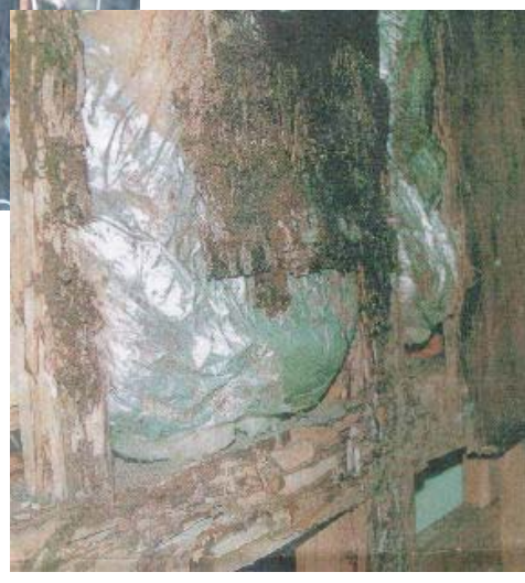
下の画像は腐食した断熱材と下地材です。内部結露により、腐食している事が分からなかった為、症状は進行しており構造材（柱など）が虫食い状に腐っています。
