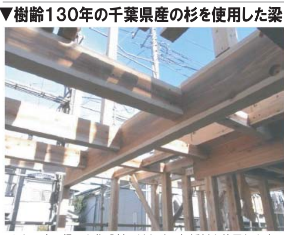
▼樹齢130年の千葉県産の杉を使用した梁 こんなに太い梁でも集成材ではなく、無垢杉を使用します。白黒画像だと分かり難いですが、杉の中心部の色が濃い部分である心材を使用しているのが腐食や強度がとて強いです。
