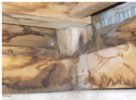
図2 結露により痛んだ土台
